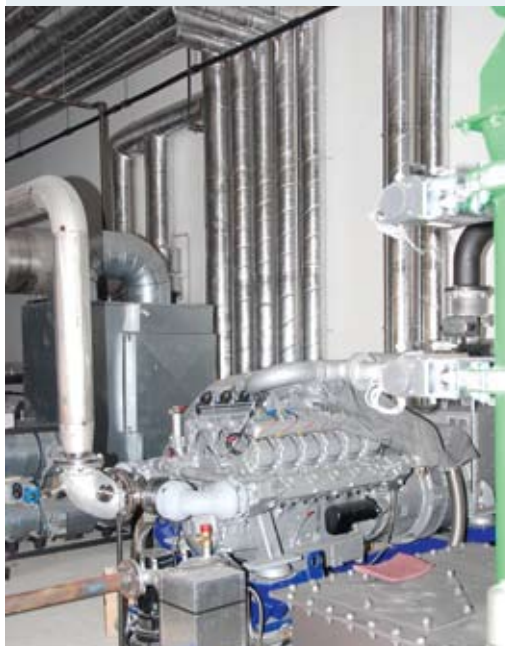
Im Vordergrund ist der Motor des BHKW zu sehen, im Hintergrund Teile des Abgasreinigungssystems (Katalysatoreinheit).
